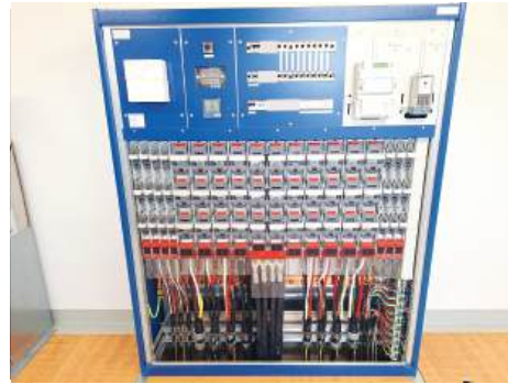
Niederspannungsverteilung Trafostation Oberwilerstrasse
