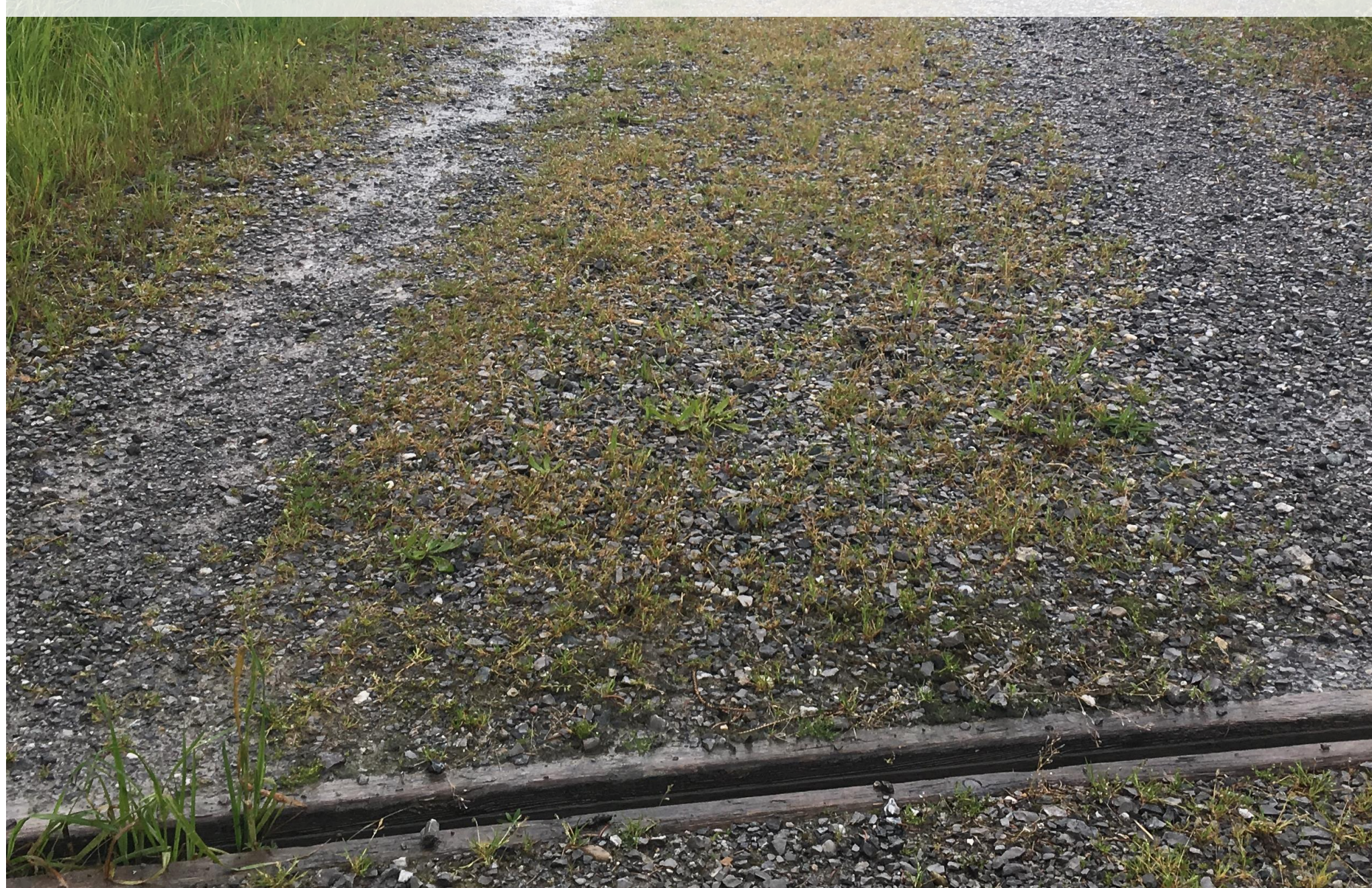
Das Herbizid gelangt hier via Entwässerungsrinnen in die Kanalisation.
