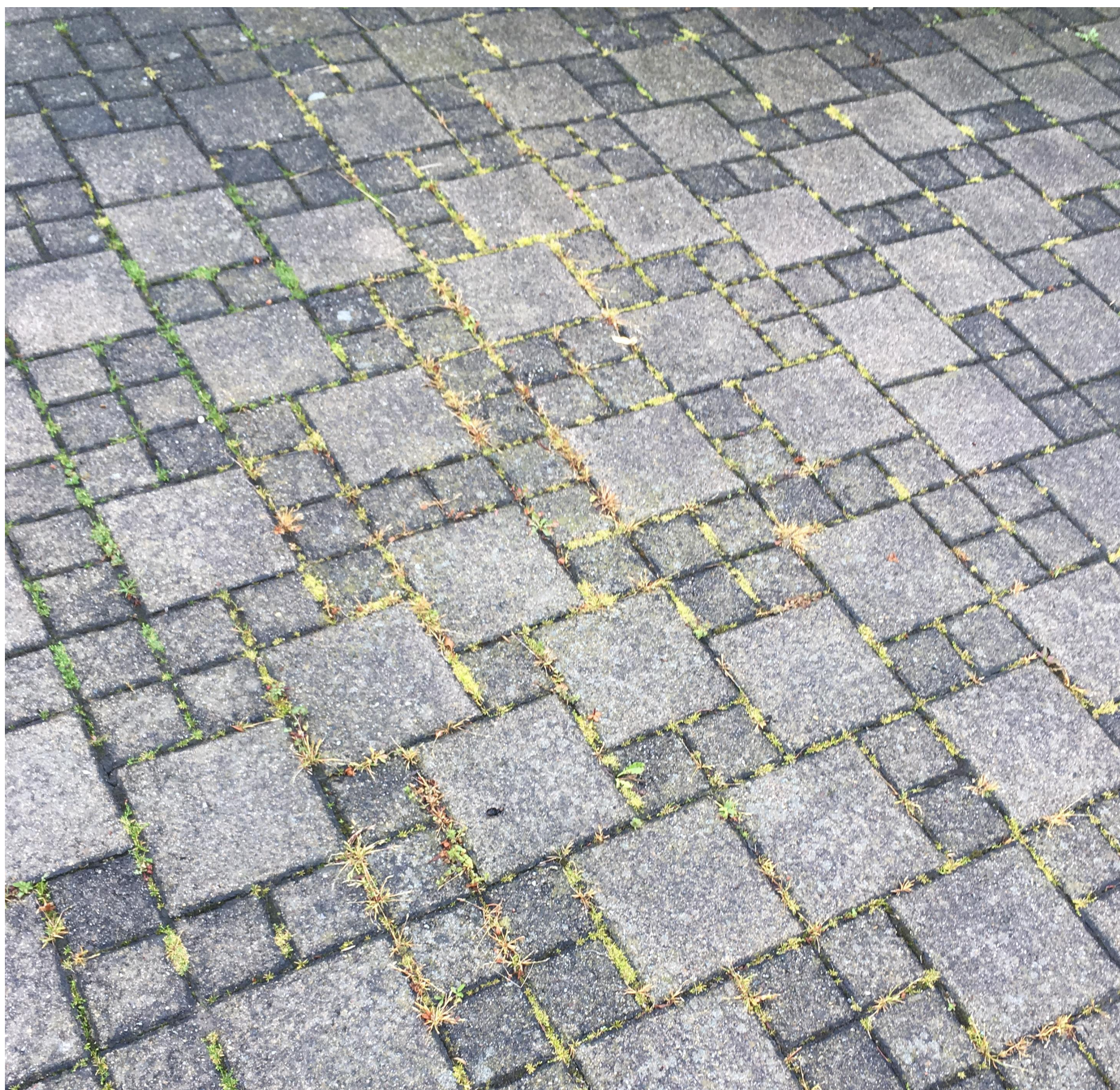
Applizierte Herbizide können durch das Kopfsteinpflaster ungehindert in Gewässer dringen.
