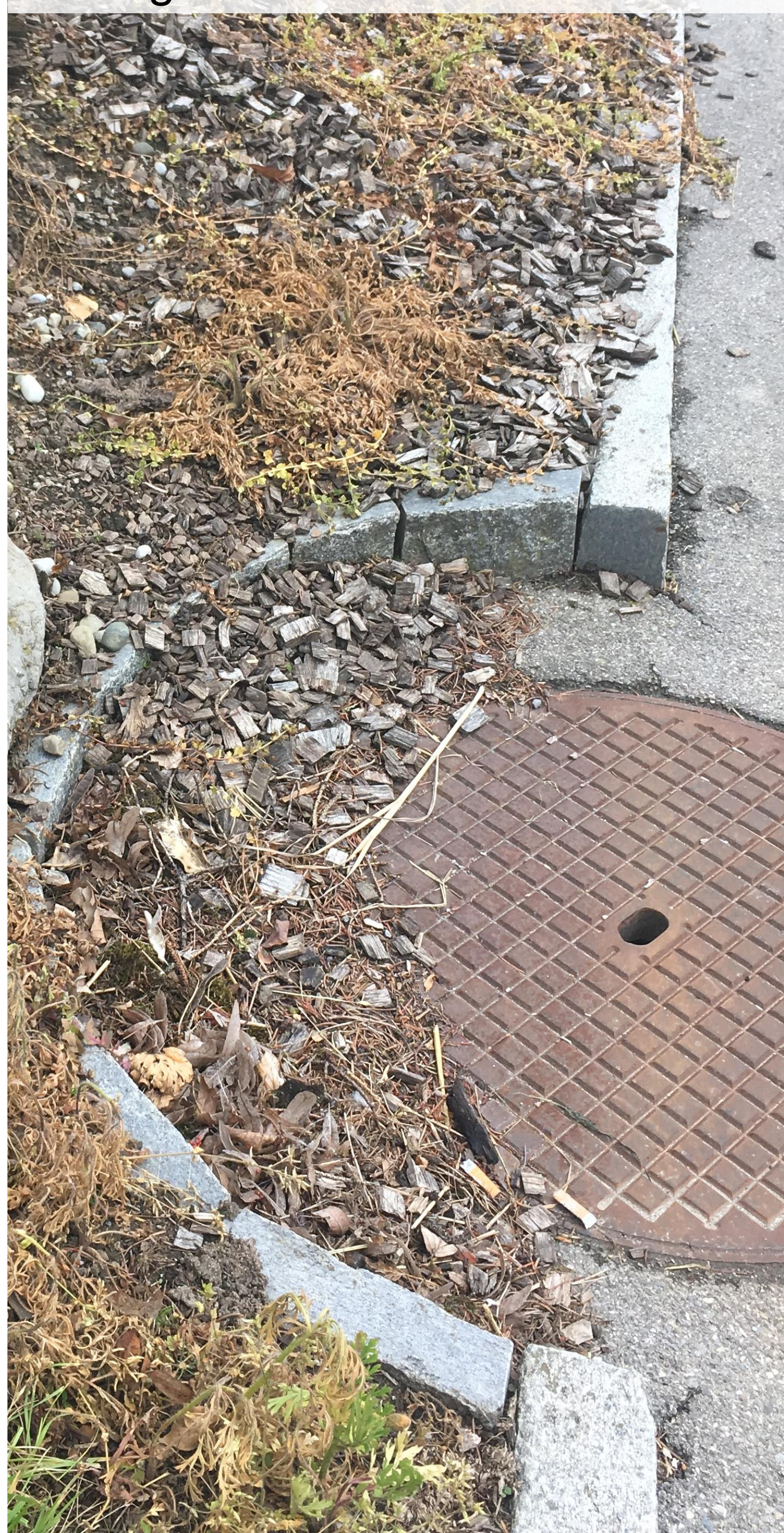
Der Einsatz von Herbiziden neben einer Dole begünstigt einen Eintrag in die Kanalisation.
